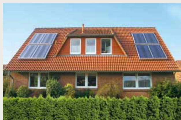
Einfamilienhaus in Lüneburg mit 8 Hybrid-Kollektoren (20 m 2 Kollektorfläche) in Aufdach-Montage. Solarertrag pro Jahr: 4.050 kWh für Warmwasserbereitung und Heizung, zzgl. 1.350 kWh Strom.
