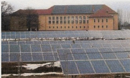
Die ehemalige Freifläche hinter dem Kulturhaus haut sich in einen Sonnenkraftwerk verwandelt. Seit Jahresanfang wird dort aus Sonnenenergie Strom erzeugt und ins Netz eingespeist. Foto: Martina Arlt/mat1Foto: Martina Arlt/mat1
